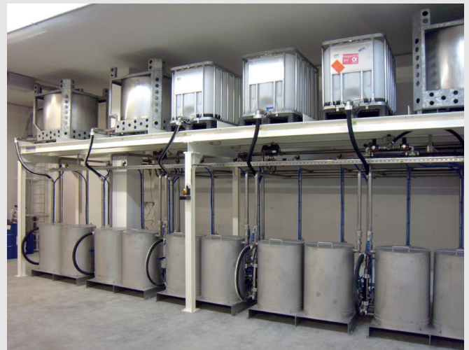
Beispiel von einem Tankpark mit festen Lagertanks und IBC Container.
